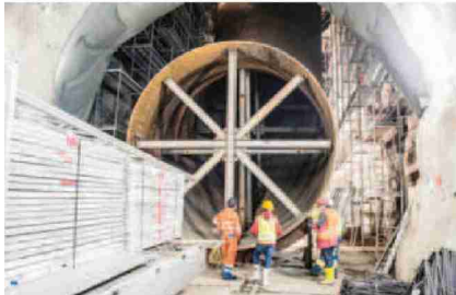
GIGANTESQUE Une impressionnante conduite forcée au pied des puits verticaux reliant le barrage du Vieux-Emosson à la salle des machines.
