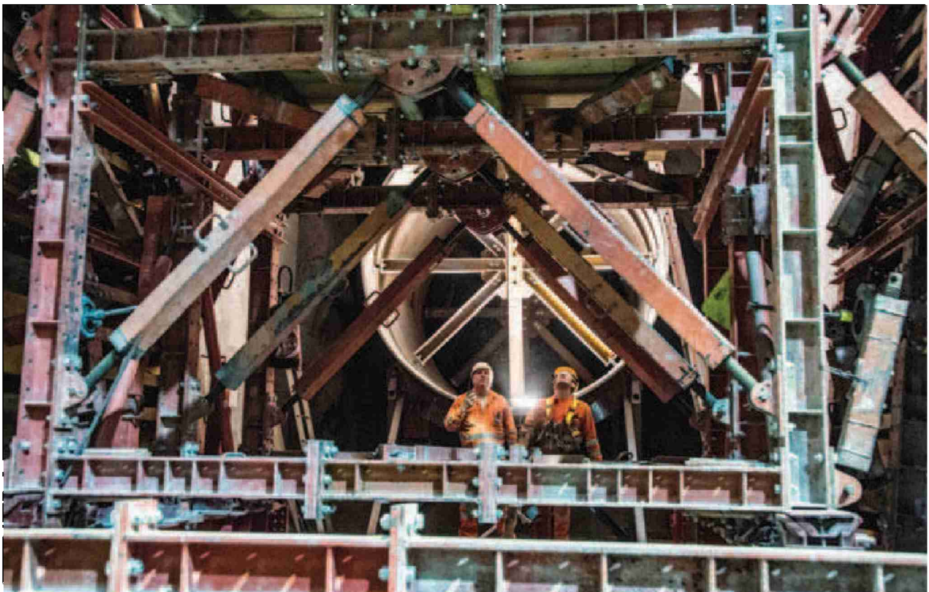
La taille des conduites actuellement mises en place et des coffrages qui serviront au bétonnage des galeries, à mettre en relation avec les ouvriers présents sur cette photo, démontrent le gigantisme du chantier en cours dans les entrailles des barrages d'Emosson.
