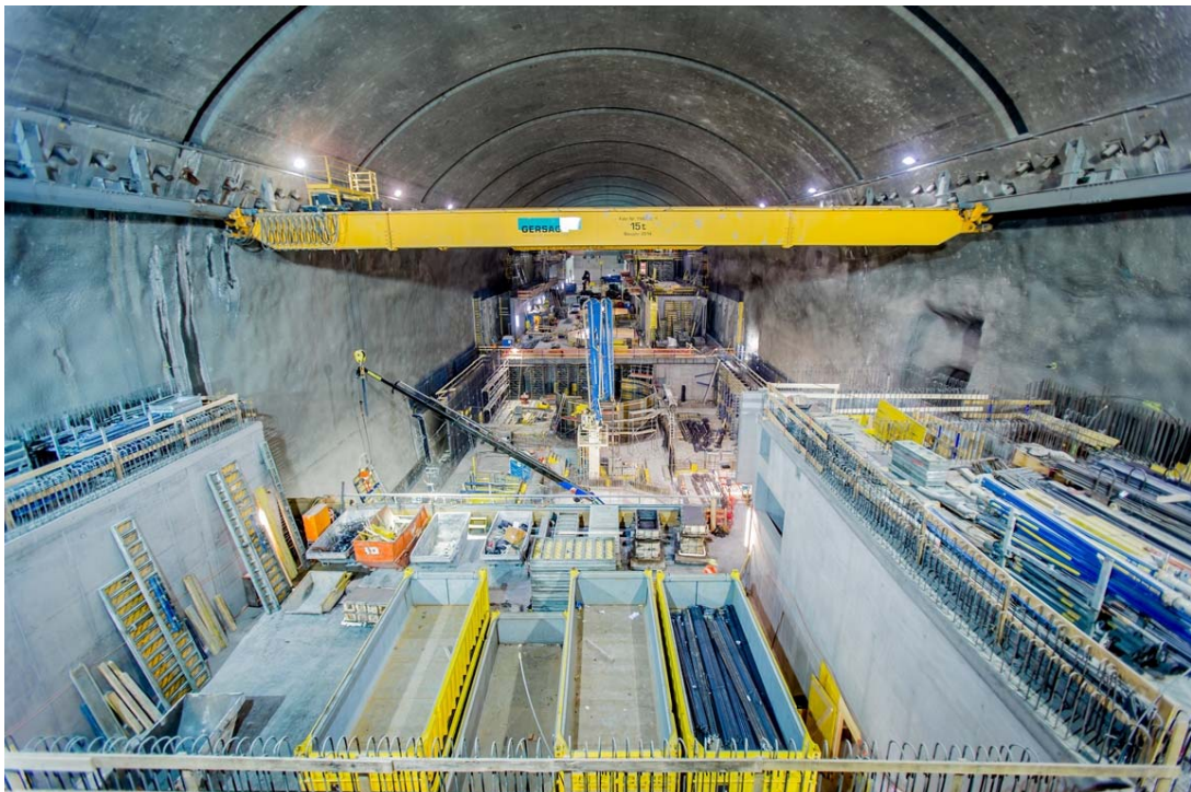
La caverne des machines en novembre 2015
