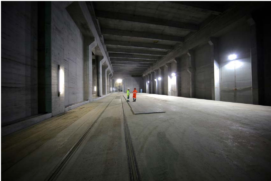
La caverne des transformateurs a été achevée en 2015.
