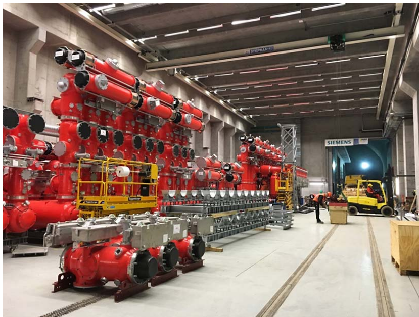
Poste de couplage GIS de Swissgrid dans la caverne des transformateurs installé par Siemens AG
