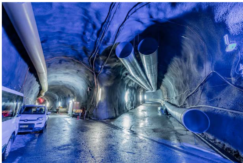
Conduits de ventilation destinés à l'aménagement intérieur des galeries.
