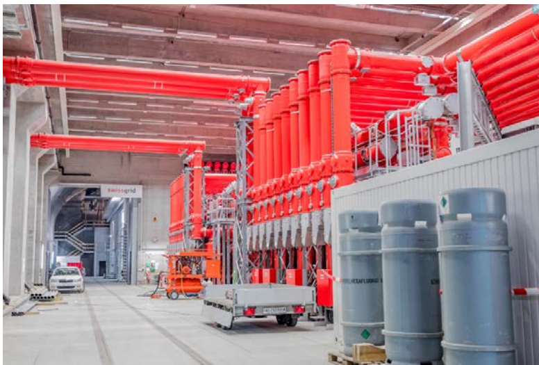
Poste de couplage isolé au gaz de 380 kV de Swissgrid dans la caverne des transformateurs.
