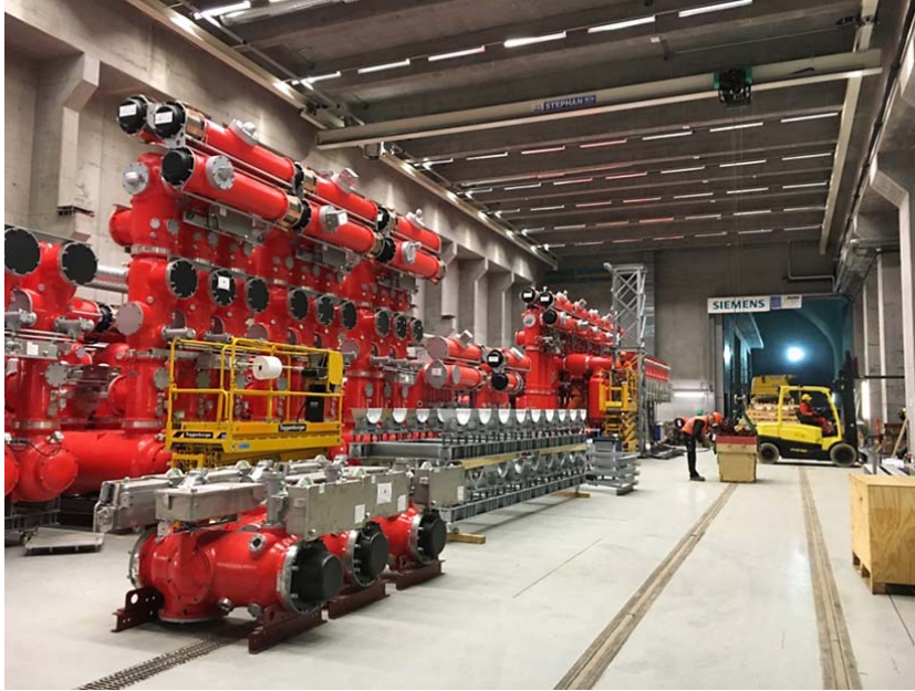
GIS-Schaltanlage von Swissgrid in der Trafokaverne installiert von Siemens AG
