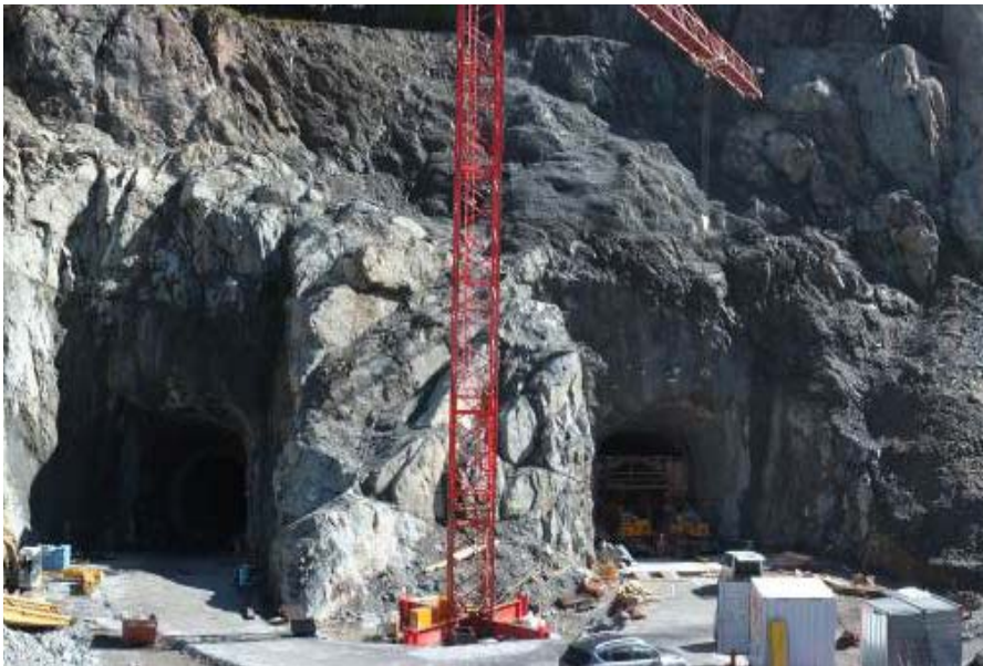
Triebwasserwege im Speichersee Vieux-Emosson
