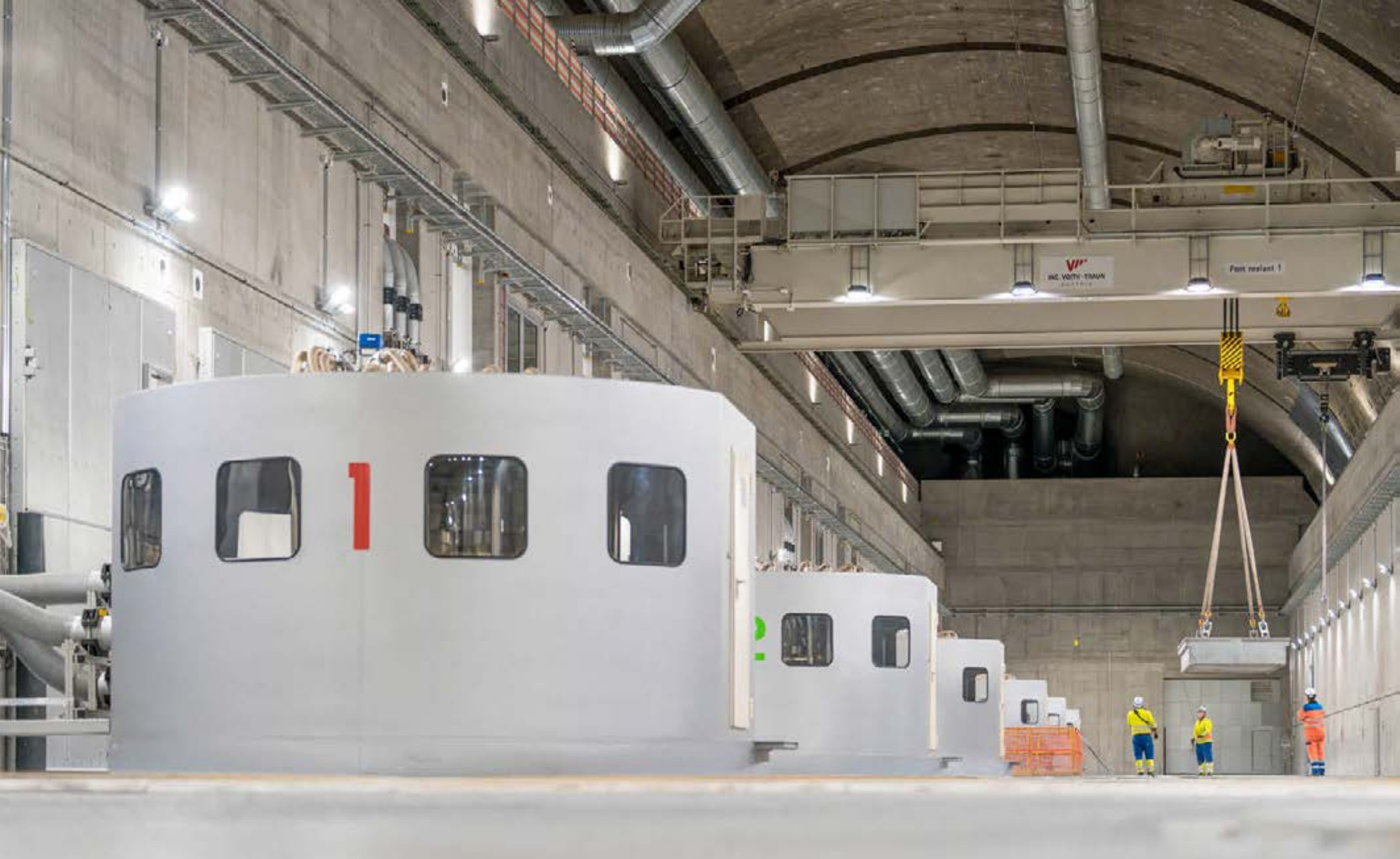
Seuls les éléments supérieurs des machines sont désormais visibles dans la caverne. On devine cependant les dimensions hors normes des six groupes, chacun hauts de 30 mètres.
