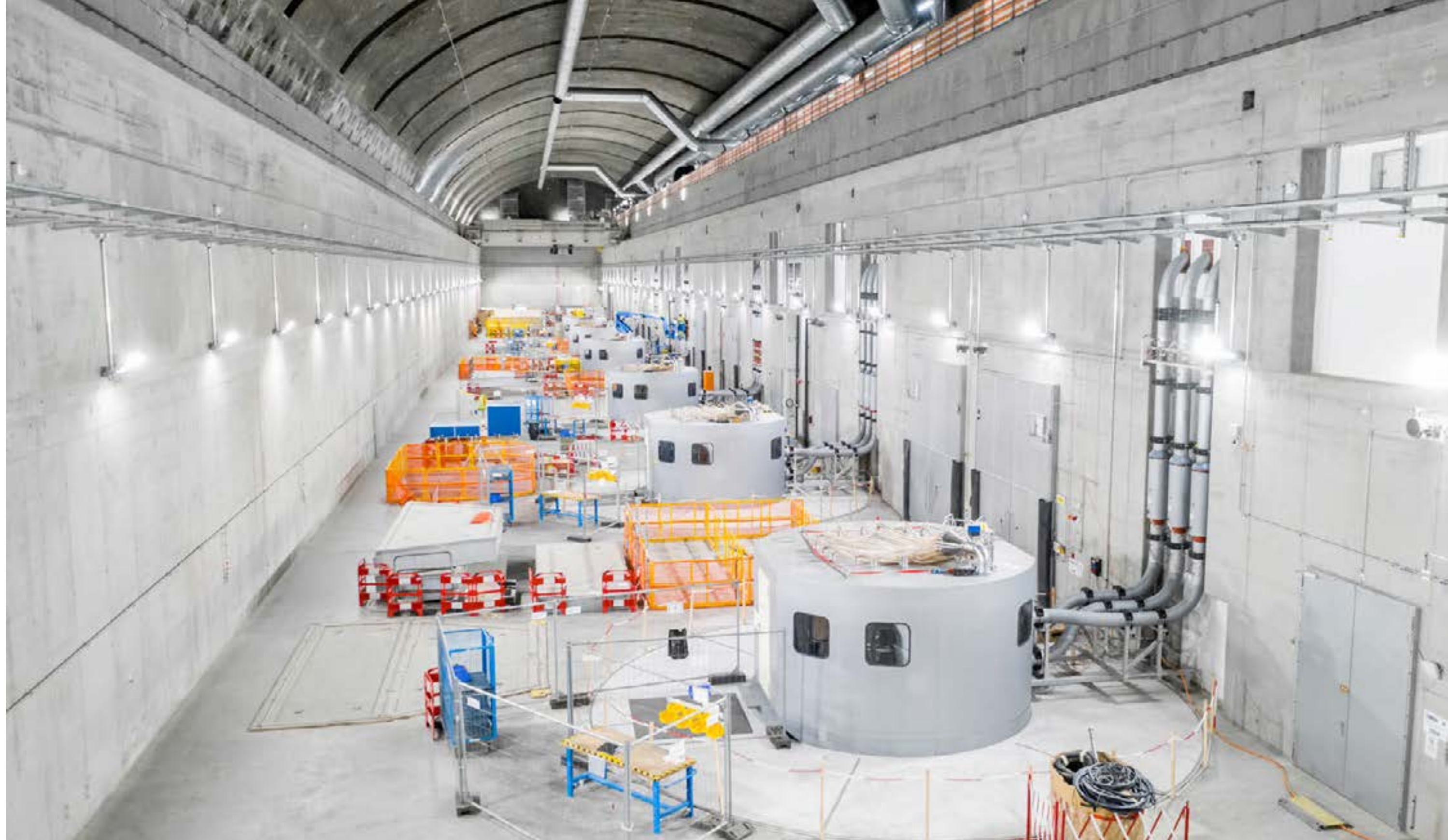
La caverne des machines en octobre 2021.
