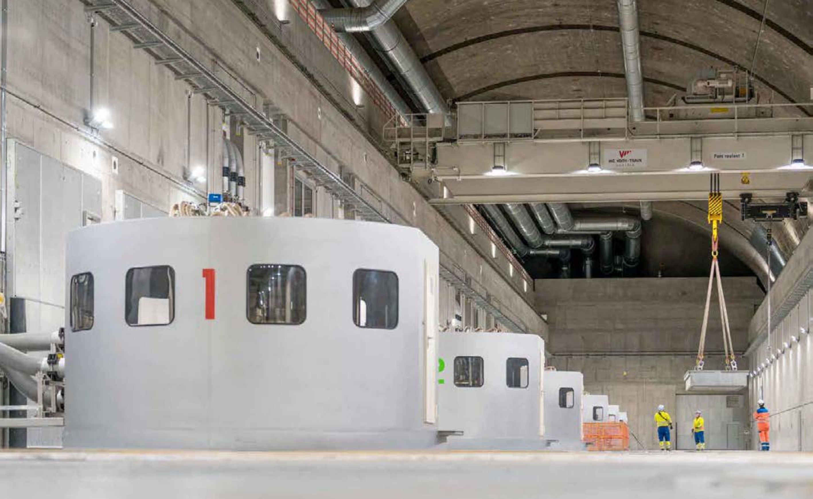
August 2022. In der Kaverne sind nur noch die oberen Teile der Maschinen sichtbar. Man kann jedoch die ausserordentlichen Dimensionen der sechs Maschinengruppen, die sich vertikal auf über 30 m erstrecken, erahnen.
